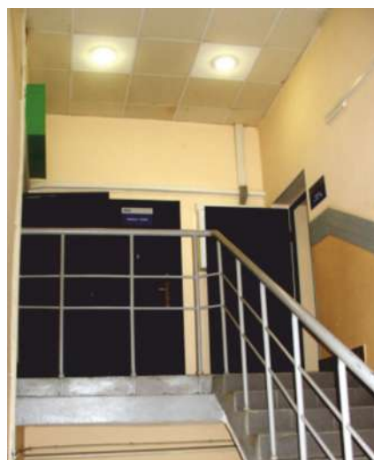
Эксплуатация светильников ССБ10 в бытовом помещении
